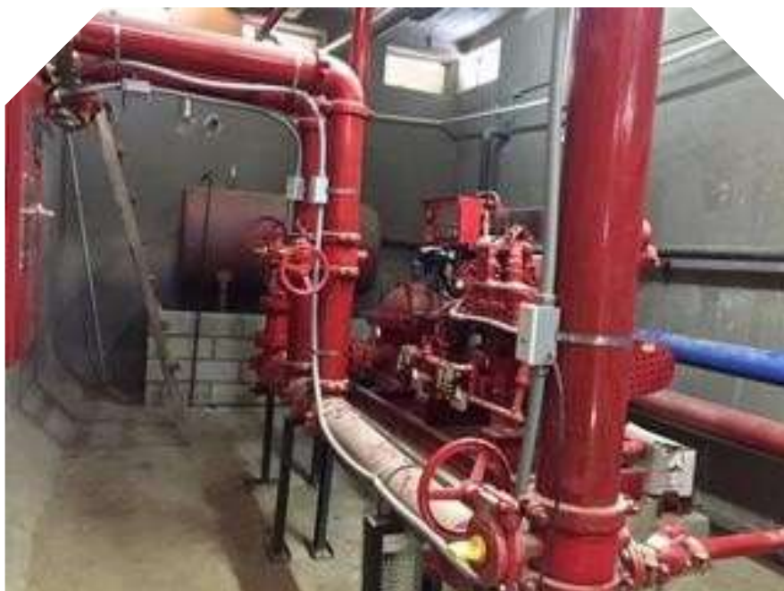
Ilustración 6 Sistema contra incendio de la Universidad del Magdalena. Fuente: Propia
